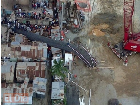
Varias viviendas debajo del puente de la 17 fueron afectadas al caer una columna de varillas sobre ellas. Una señora y su niña recién nacida resultaron heridas.
